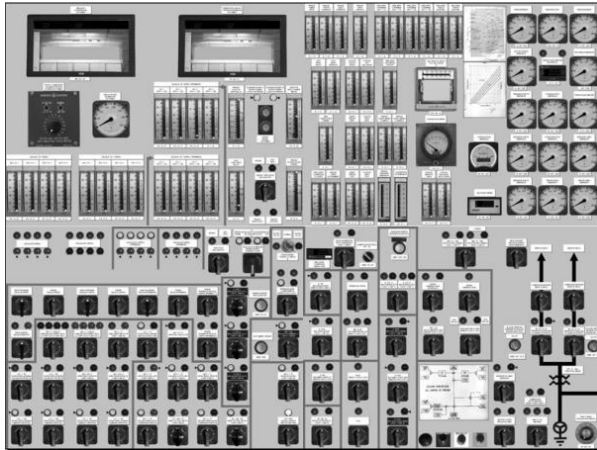
Figura 4. Composición de cuatro paneles virtuales correspondientes a los sistemas de control de turbina y generador eléctrico.
